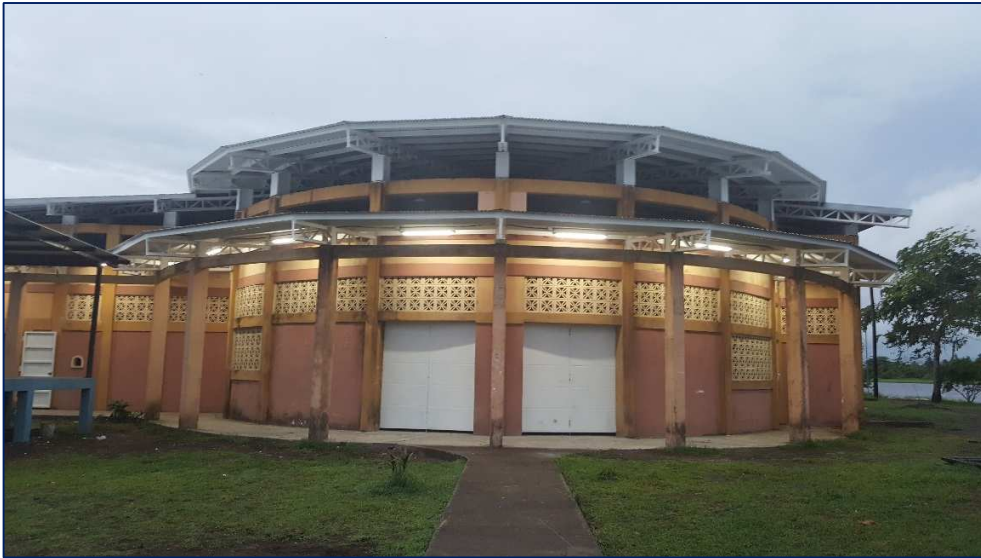
Apreciar en la fotografía situación de las instalaciones sin proyecto.
